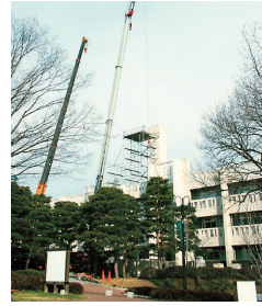
A棟：常磐短期大学開学時からシンボルであったA棟の時計塔は、ひび割れ等の被害が大きいため撤去されました。
