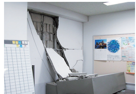
D棟：各所の柱や梁にひび割れや損傷が数多く発生しました。現在復旧方法を検討中です。
